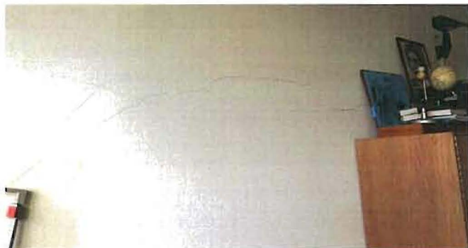
Slika 1. Karakteristično oštećenje: Pukotine u pregradnim zidovima nove škole usled sleganja.
